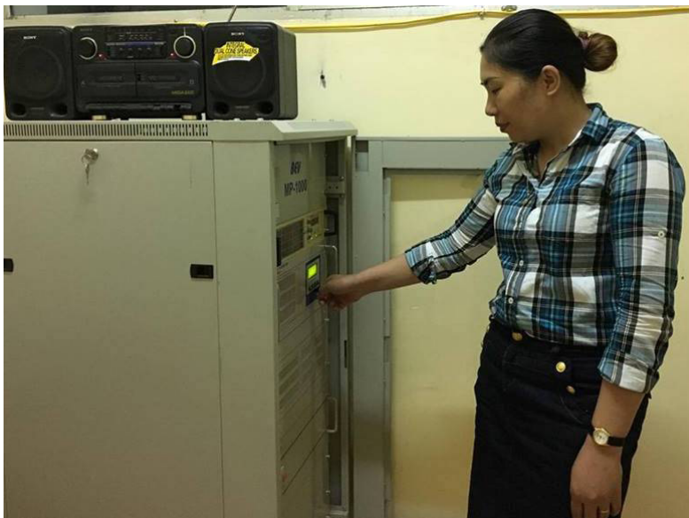
Cán bộ kỹ thuật Đài TT - TH thành phố Điện Biên Phủ vận hành máy phát sóng FM 1000 KW
